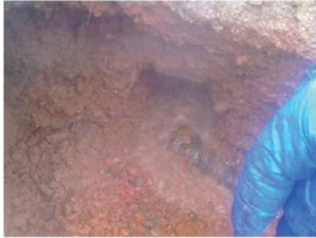
Şekil 20. Tespit edilen en yüksek su kaçağı bölgesi kazısı (Hamilton ve McKenzie, 2014)
